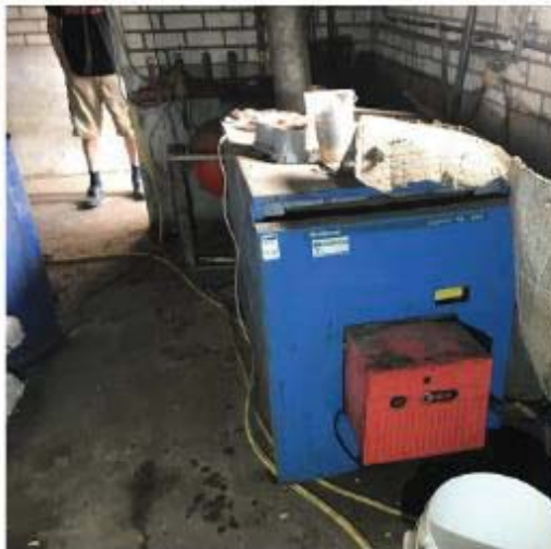
C.v. installatie stal 1
