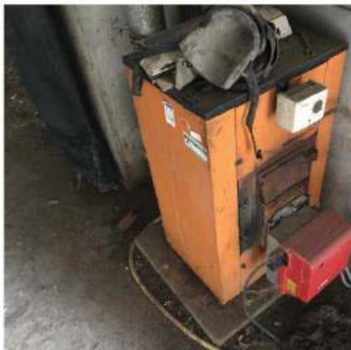
C.v. installatie stal 3
