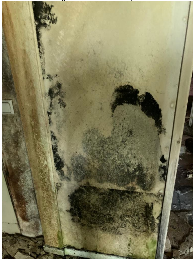
• Afbeelding 13: vocht- en schimmelplekken
