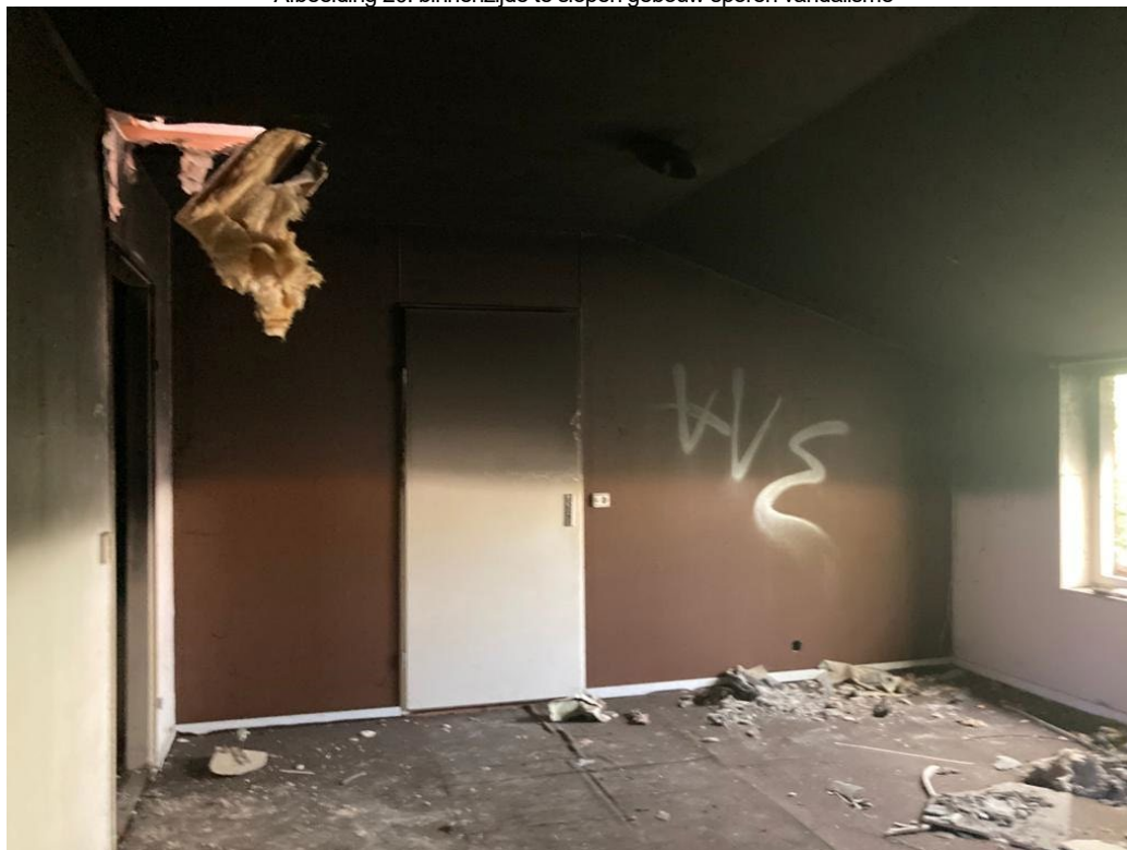
• Afbeelding 20: binnenzijde te slopen gebouw sporen vandalisme
