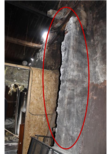
Deels verwijderd schoorsteenkanaal
