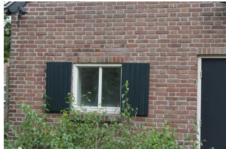
Later aangebracht venster in de kopgevel met inboetwerk boven het venster
