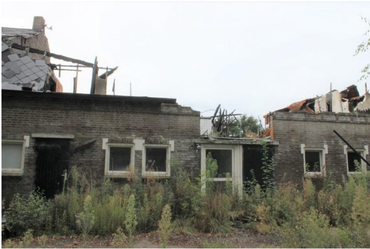
Rechter zijgevel van het beschadigde bedrijfsdeel
