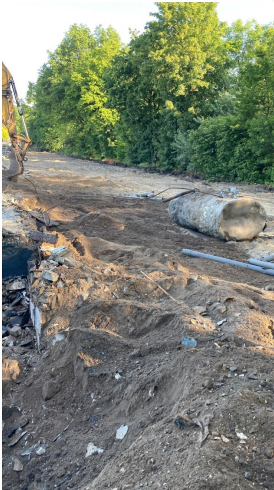
Figuur 52: Ondergrondse tank RE5
