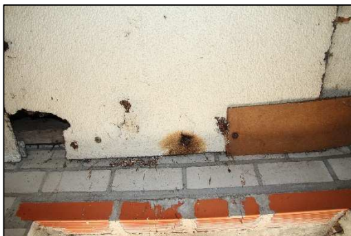
Foto 7. (vraat)schade aan het plafond van de schuur
