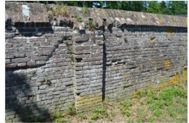
Metselwerk plaatselijk zeer slecht
