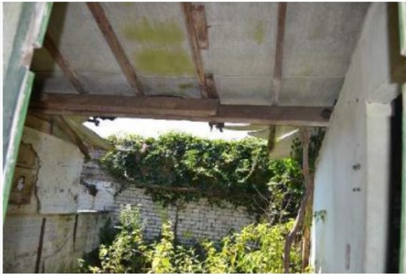
Slechte staat bouwwerk
