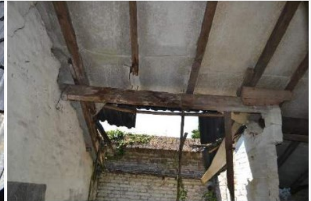
Ontbrekende muurplaat en sporen van dak B-02-01
