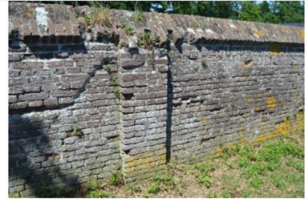
Metselwerk plaatselijk zeer slecht
