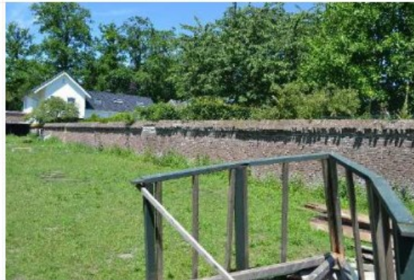
Ontbrekende/afgebroken metselwerk van ezelsruggen
