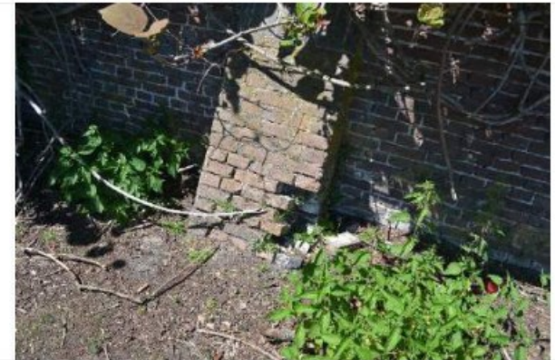
Slechte staat metselwerk van steunberen
