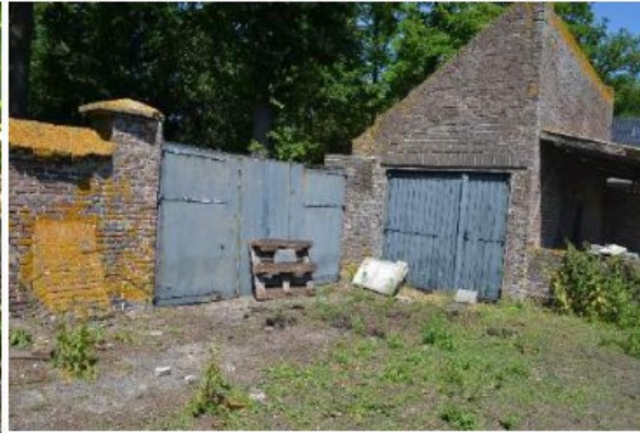
Ontbreken afdekplaat op pijler
