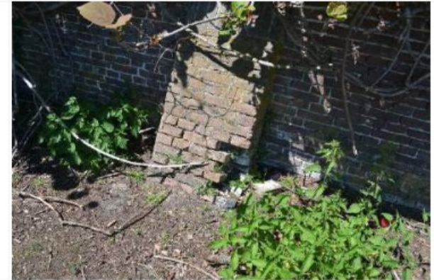
Slechte staat metselwerk van steunberen
