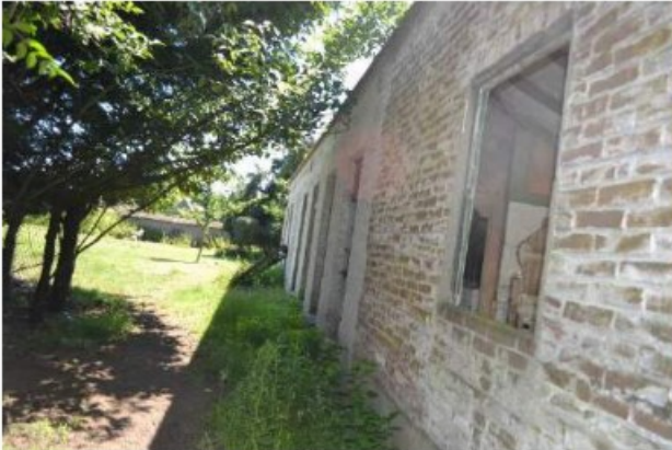
Ontbrekende deuren en kozijnen in gevel van B-02-01
