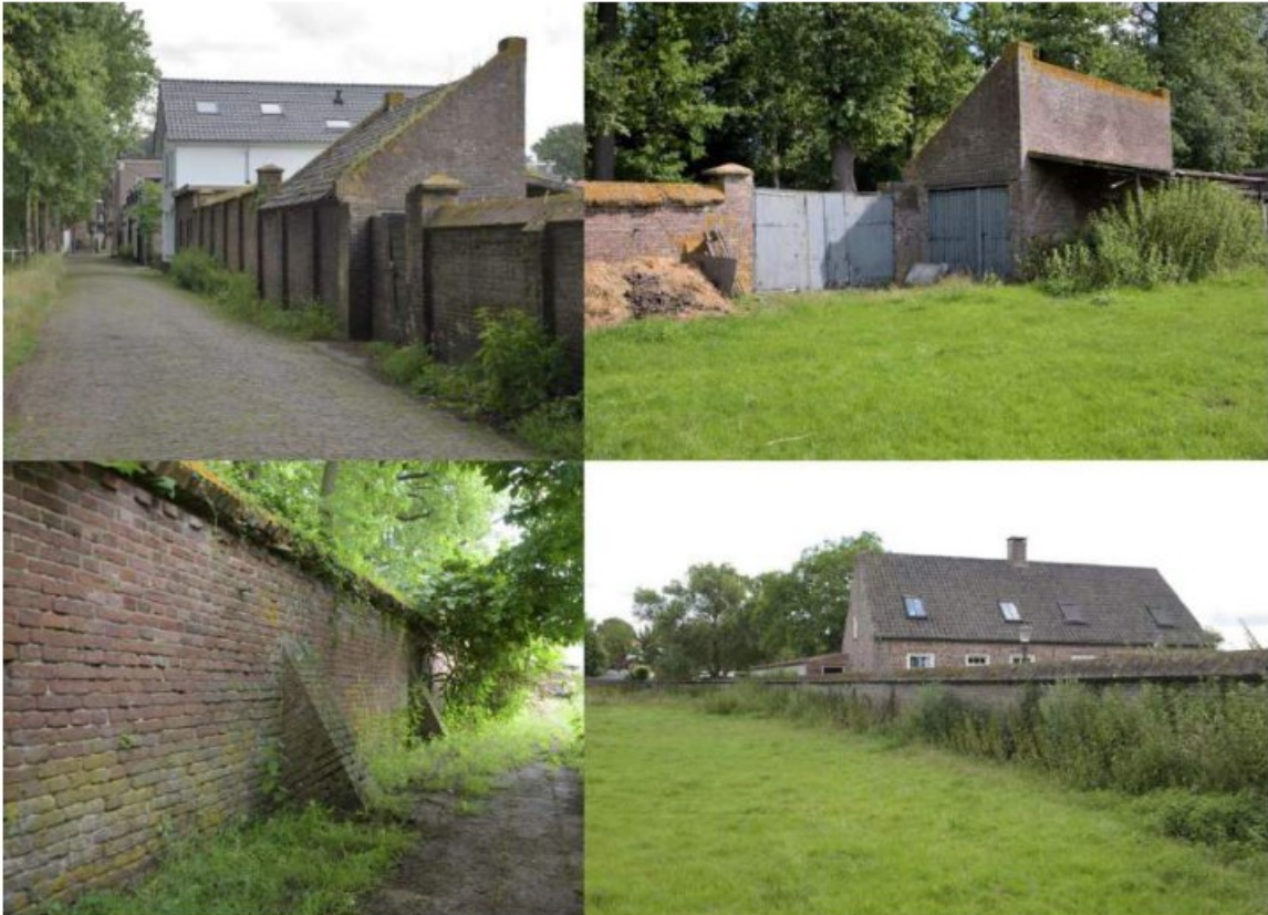
Figuur 2.1: Foto's tuinmuur gemaakt op 7-7-2021 door Constructiebureau [REDACTED]
