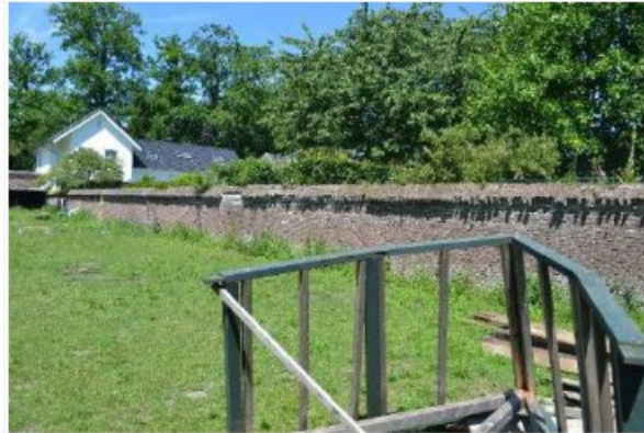
Ontbrekende/afgebroken metselwerk van ezelsruggen
