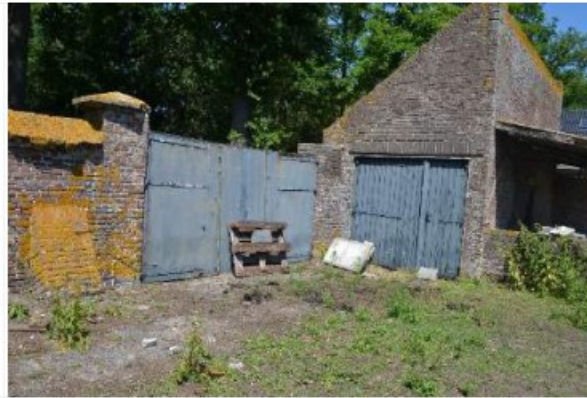
Ontbreken afdekplaat op pijler
